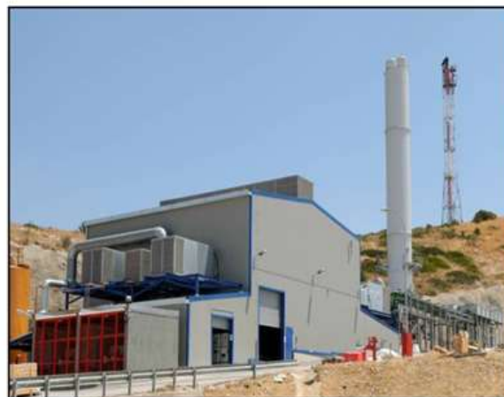
ΣΗΘΥΑ στον τερματικό σταθμό υγροποιημένου φυσικού αερίου στη Ρεβυθούσα – ΔΕΣΦΑ (13 MW)
