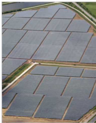
Φωτοβολταϊκός σταθμός ισχύος 10 MW σε αγροτική περιοχή της Βαυαρίας
